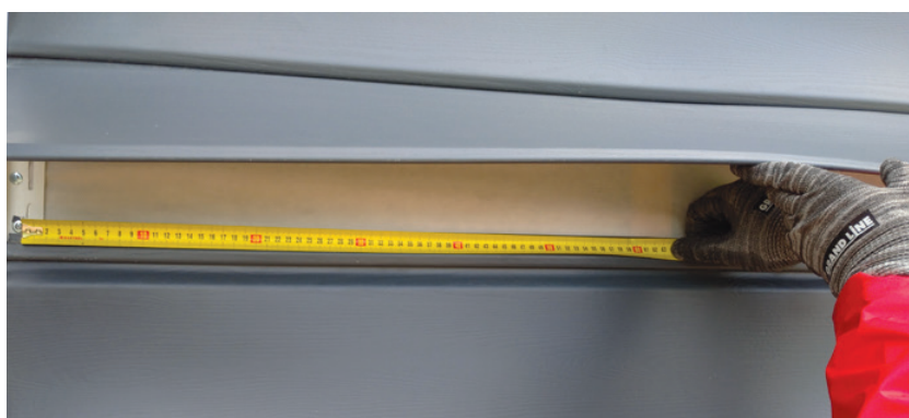
Мембрана неверно смонтирована. Должна быть смонтирована под обрешеткой. Саморезы в тело доборного элемента. Неверный шаг обрешетки.
