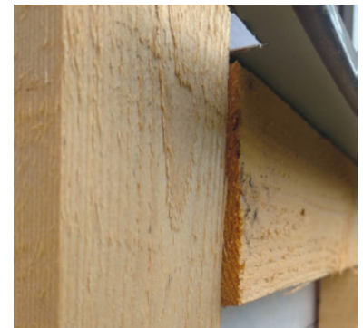
Обрешетка не в плоскости. Перекрыт вентиляционный канал.
